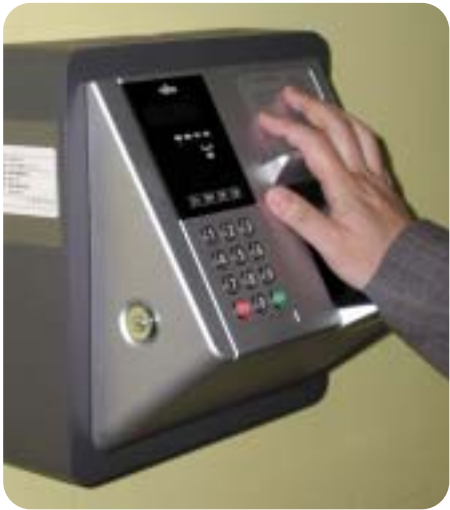
CBTサーバー室を守るセキュリティ
