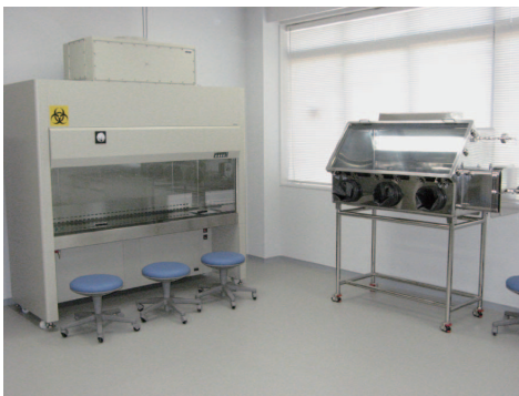
注射調剤室（グローブボックスも完備）
